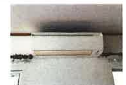
1階リビング・エアコン
